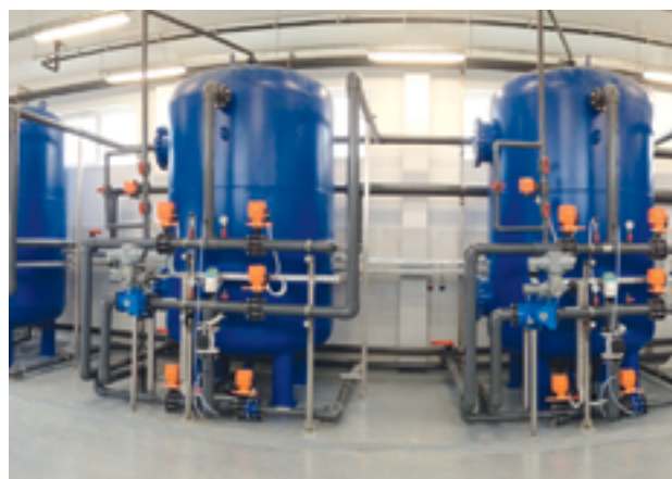
Установка очистки питьевой воды с песчаными фильтрами, Вировитица, Хорватия
